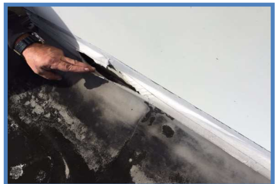
Openstaande naad tpv doorvoer
